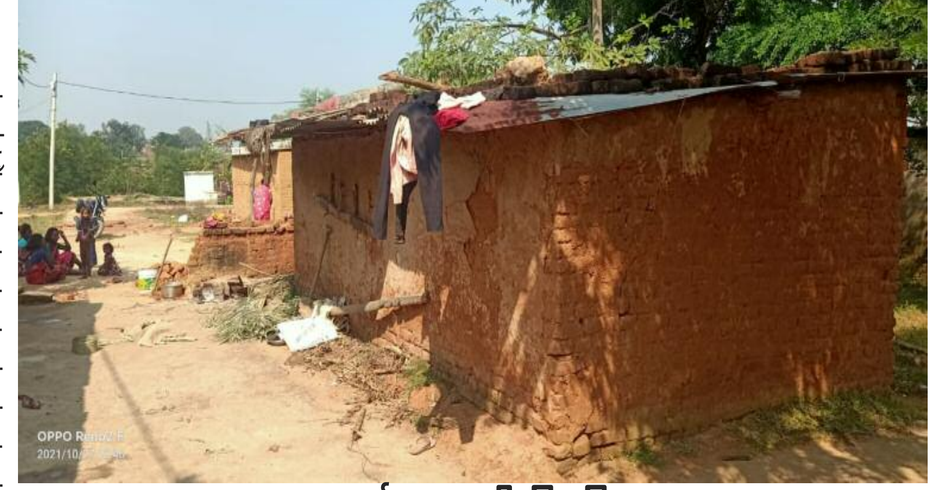
जर्जर घर की स्थिति
