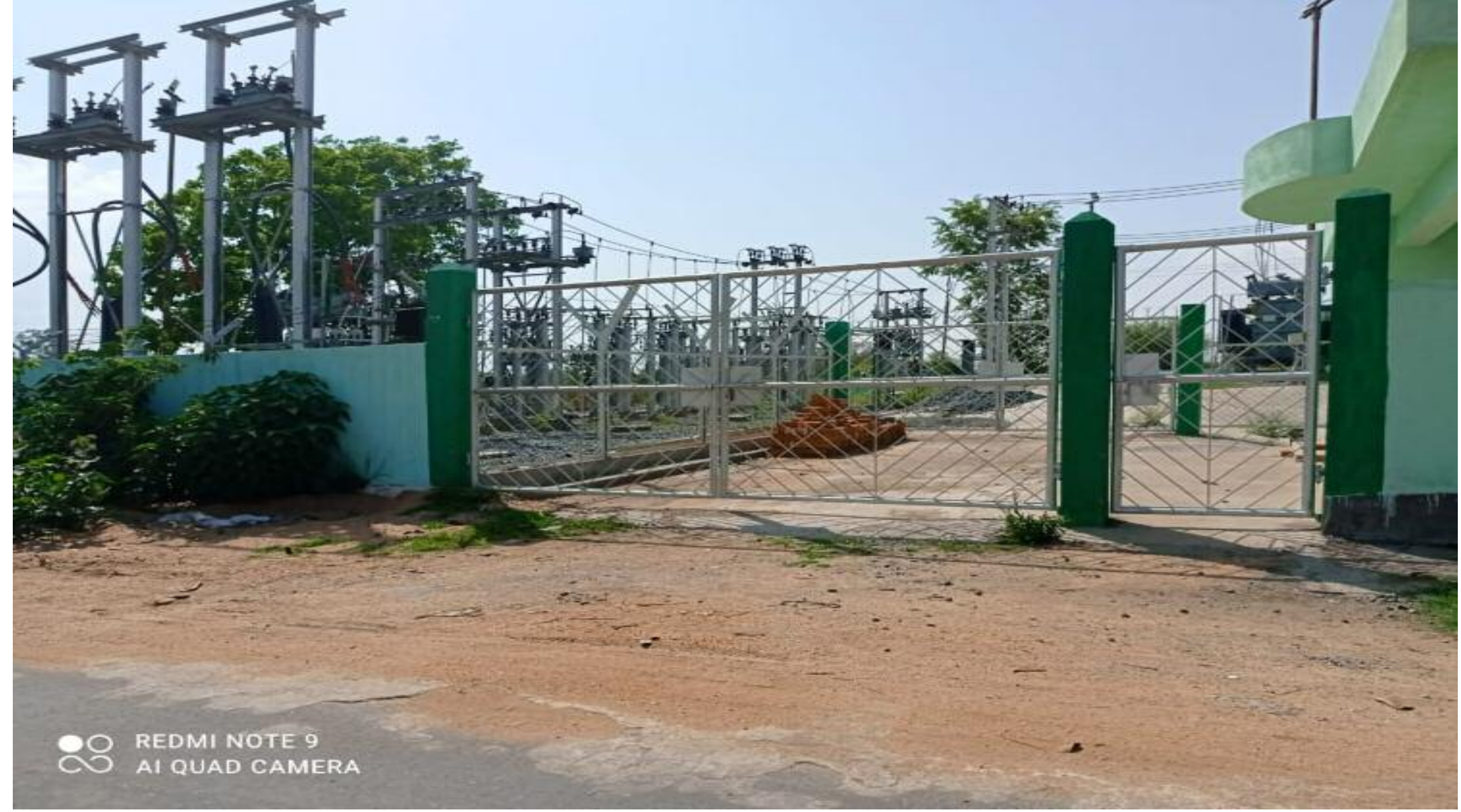
हरली बिजली सबस्टेशन
