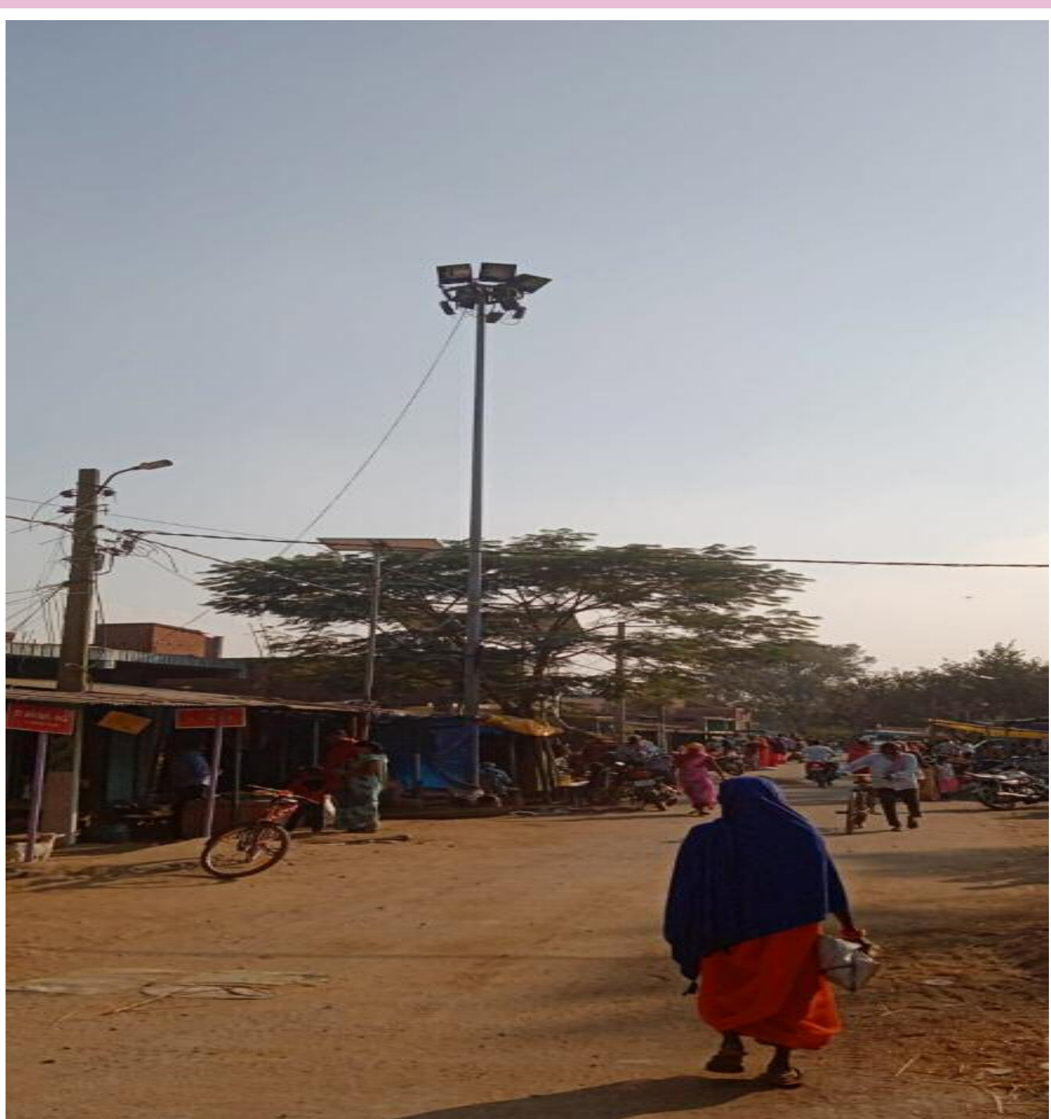
खराब पड़ा स्ट्रीट लाइट
