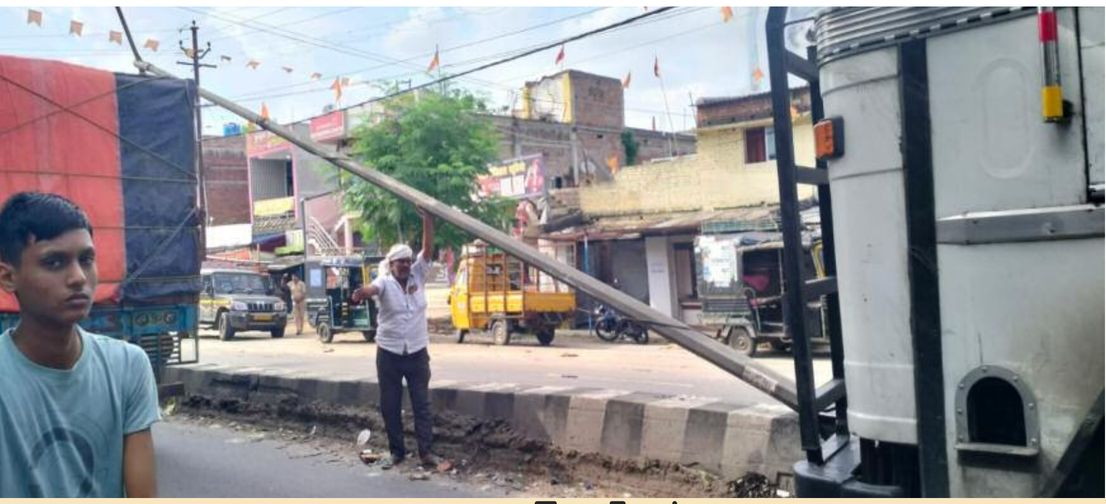
टूटा हुआ बिजली खंभा
