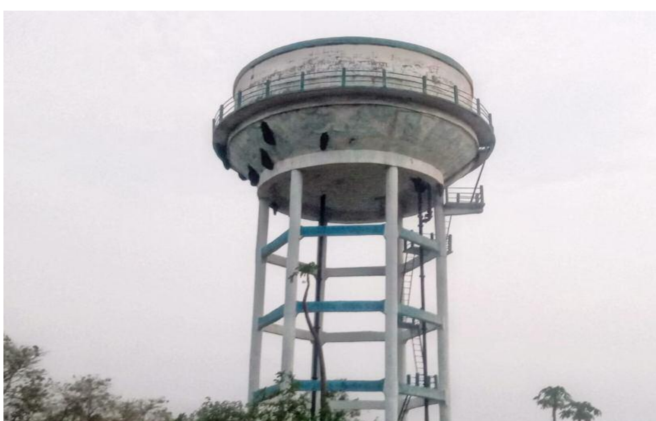
विष्णुगढ़ ग्रामीण जलापूर्ति योजना का सूखा पड़ा जलमीनार
